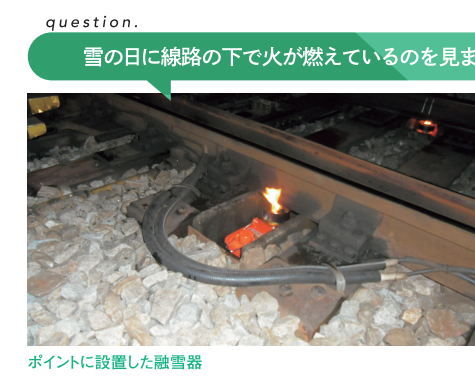
ポイントに設置した融雪器
